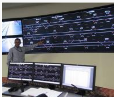
Puesta Central de Operaciones - PCO
